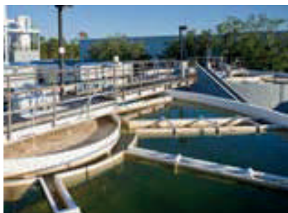
Водоподготовка и очистка
