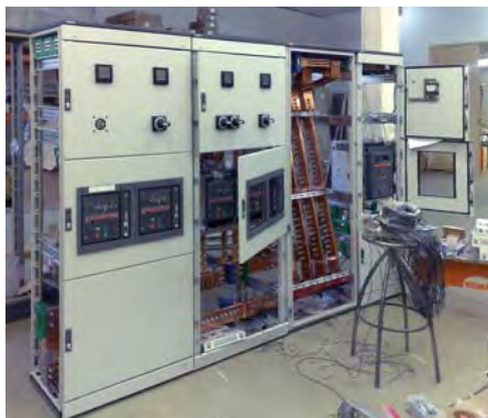
Системы управления Коммутация в шкафах управления промышленным оборудованием
