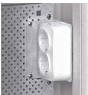
Розетка для подключения активного оборудования.
