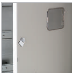
Оперативная панель имеет окно для снятия показаний электросчетчика и прорезь для доступа к аппарату защиты и крепится к корпусу при помощи петель и запирается индивидуальным замком-защелкой.
