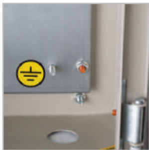
Шпилька заземления на монтажной панели.
